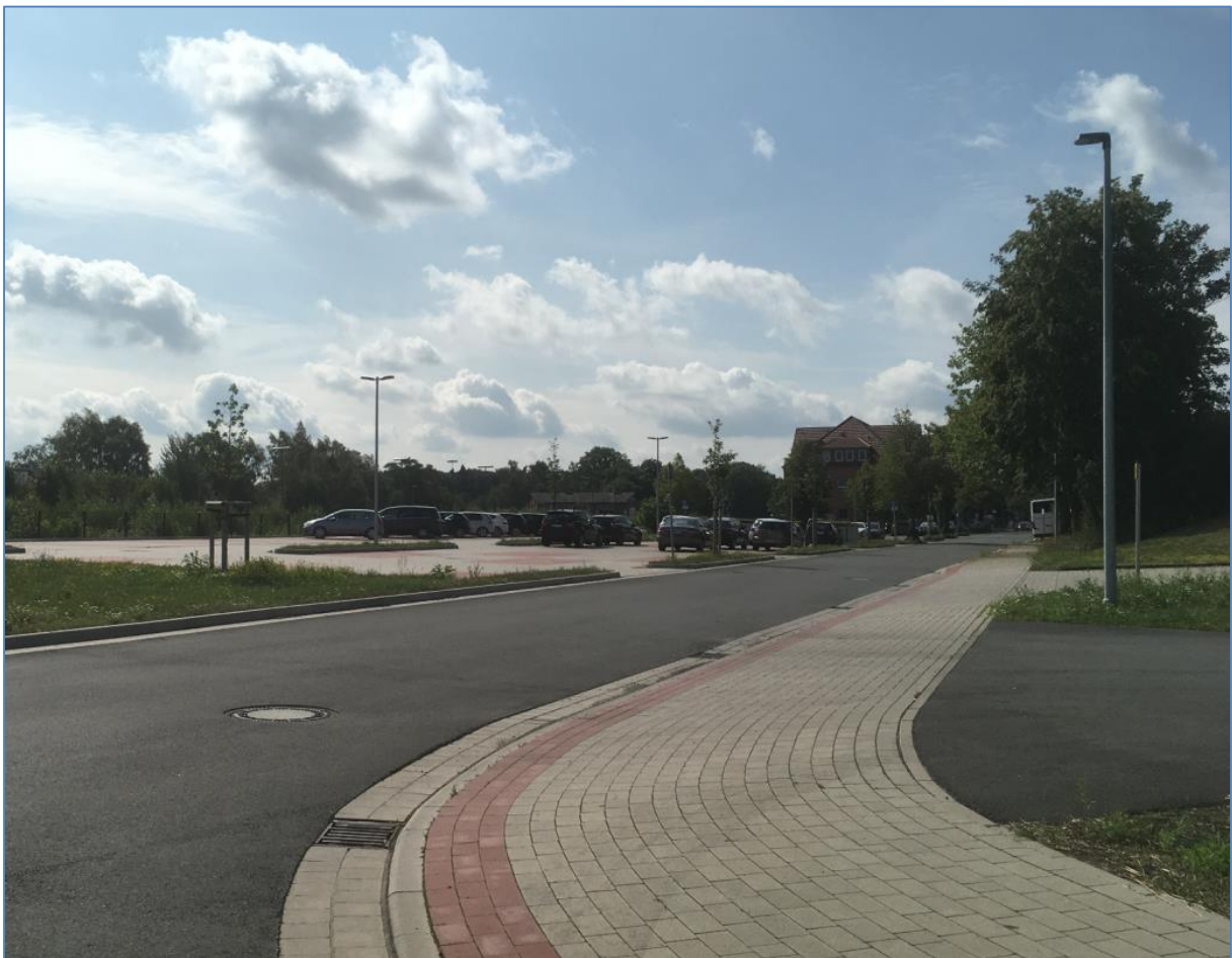
Abbildung 17: Neu hergestellte Straße „Am Bahnhof“ mit Fuß- und Radweg sowie der ebenfalls im Rahmen der geförderten Sanierung neu hergestellten „Park and Ride“-Anlage.
